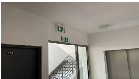
Zdjęcie nr 36: Oznaczenia drogi ewakuacyjnej
